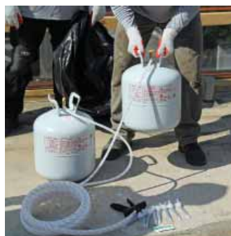
Agite los tanques de lado A y lado B
