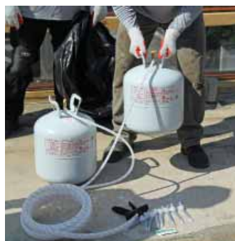
Agitation des réservoirs côté A et côté B
